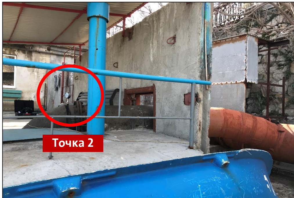
Рисунок 2.4 - Место установки манометра для измерения давления в водоводе
