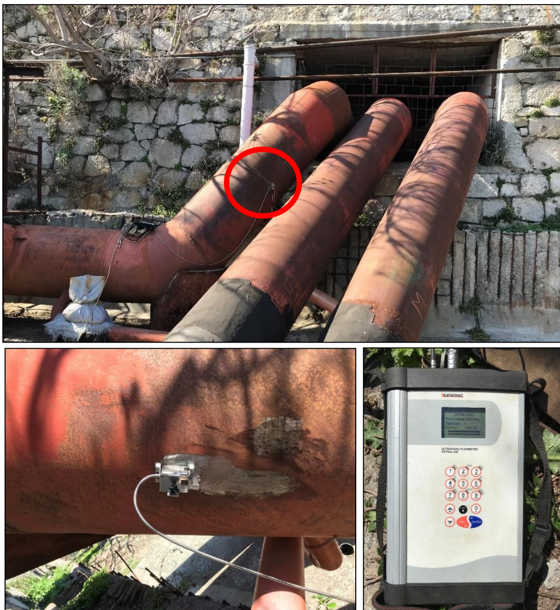
Рисунок 2.1 - Место установки расходомера на водоводе
