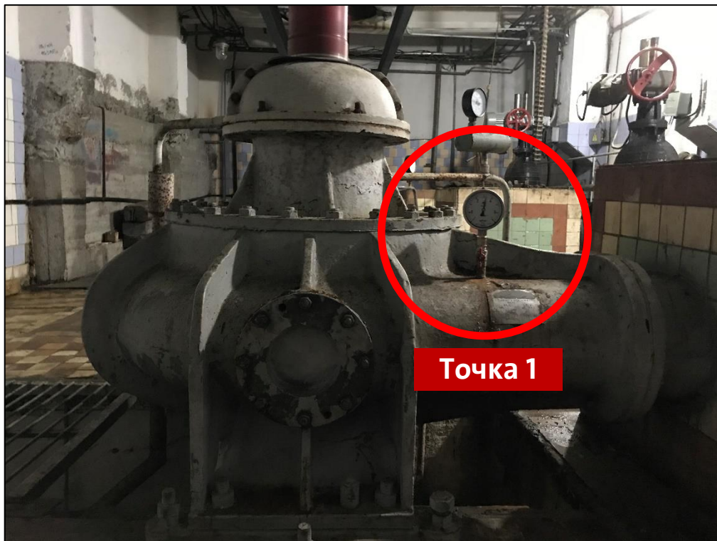
Рисунок 2.3 - Место установки манометра для измерения давления в напорной линии после насоса перед дроссельной задвижкой
